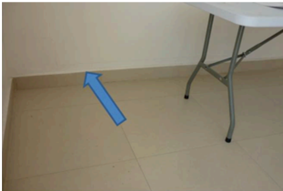
Grieta longitudinal de 4.50 ml, en la sala de espera.
